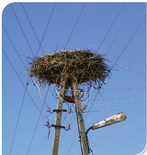
Gniazdo na linii energetycznej z przewodami „gołymi”. Fot. AT
